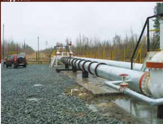
Рис. 8. Внешний вид стенда мониторинга скорости коррозии
