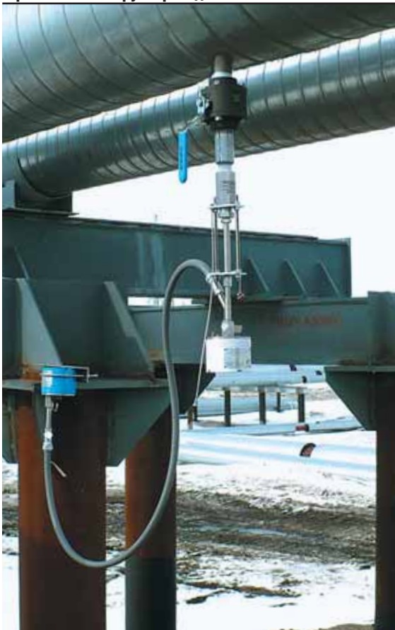
Рис. 5. Зонд для отслеживания агрессивности среды, установленный по нижней образующей промышленного трубопровода
